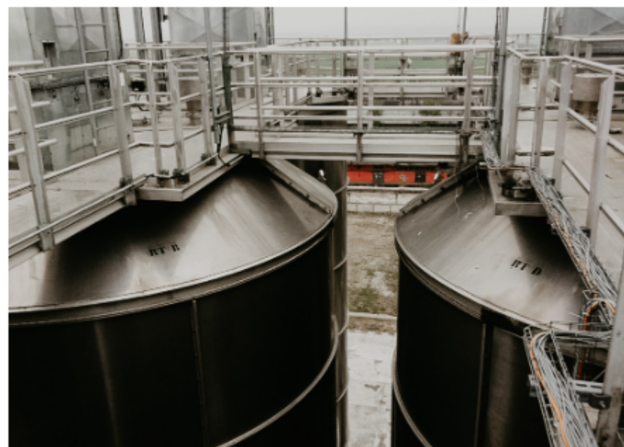
Puente de silo con dispositivos de llenado y ventilación y sensores instalados para supervisar el nivel de llenado
