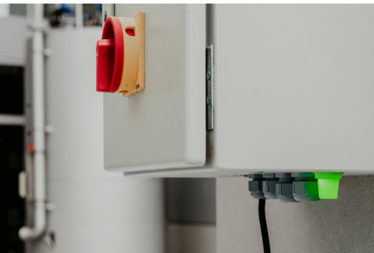
Gabinete de control
